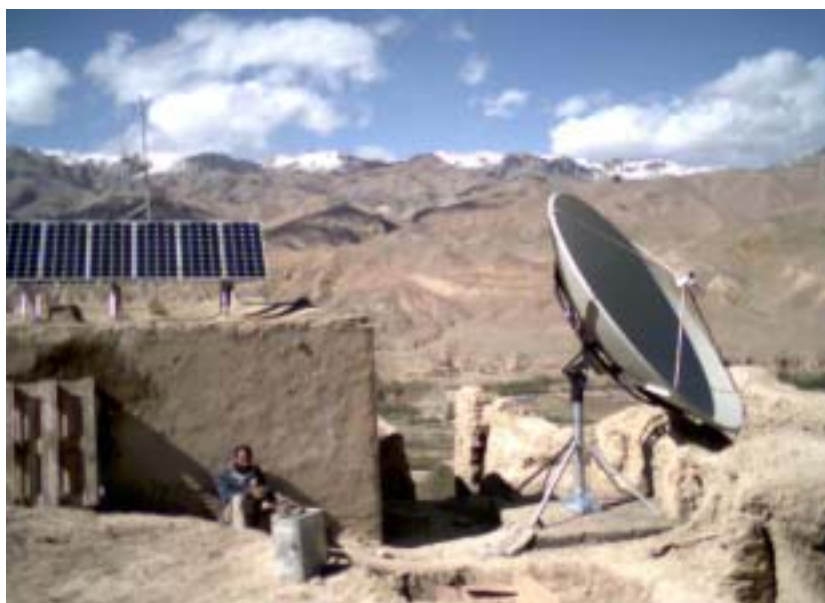
Emetteur FM de BBC World Service à Bamian, alimentée par énergie solaire
